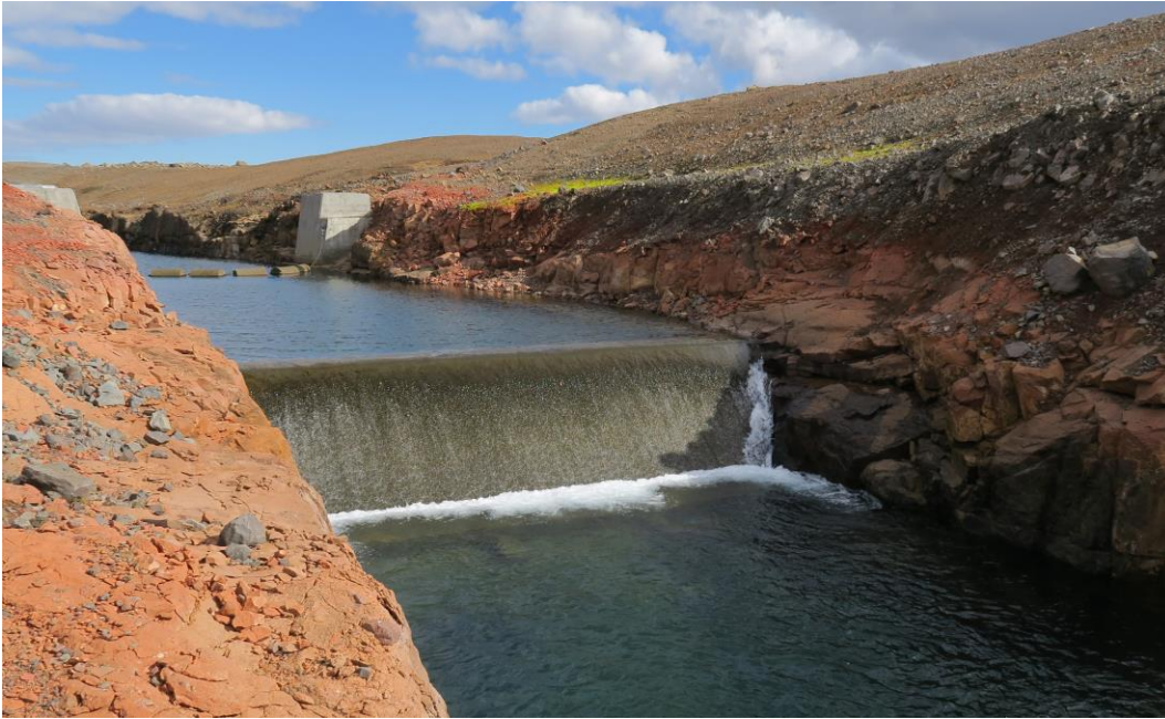
Yfirfallsveggur í manngerðum skurði í útfalli Sauðárvatns til Innri Sauðár. Ljósmynd IRJ.
