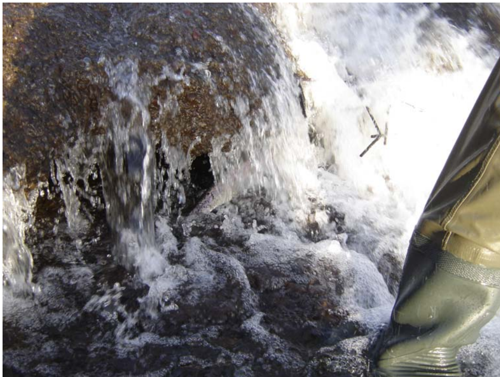
4. mynd. Farið er að grafa undan steypunni neðan við ræsið og steypujárn standa út í vatnið. Þarna reyndist lax liggja og sést í stirtlu hans fyrir miðri mynd (ljósmynd Ingi Rúnar).
